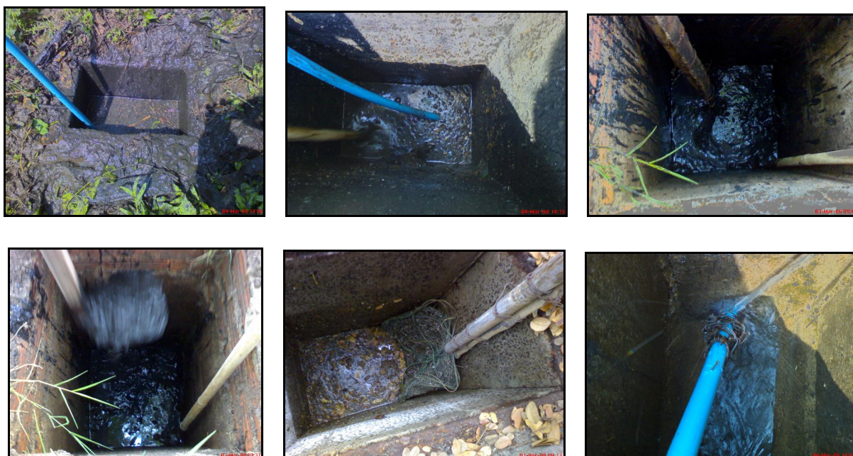
รูปภาพแสดง : สภาพแนวท่อน้ำเสียอุดตัน และวิธีการแก้ไข
